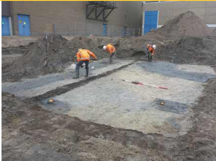
Impressie veldwerk tussen de hoogspanningsgebouwen.
