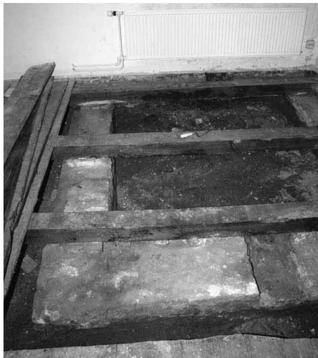
Afb. 11. Amsterdam * Spuistraat 32. De vloerbalken in het achterhuis van Spuistraat 32 rusten op opvallend zwaar metselwerk van een voorganger (foto: Bureau Monumenten en Archeologie, J. Veerkamp).
